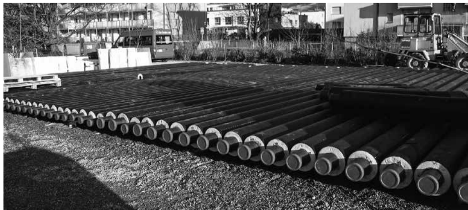
Rund acht Kilometer Leitungsnetz betreibt die Genossenschaft Stans selber.
